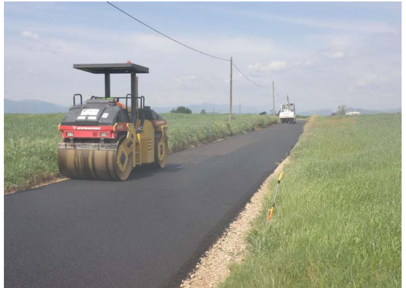
Detall de les obres al camí de Llebrers de Baix a Campllong.
