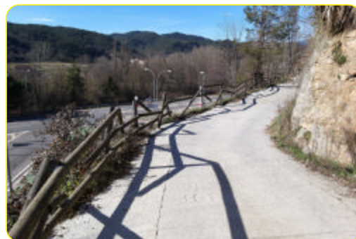
Tanques en mal estat al Raval de Sant Pere
